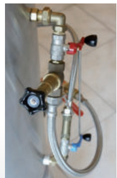
■ Tuyaux et robinets de remplissage
